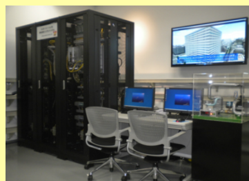
ビル制御システム
