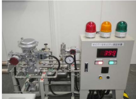
ガスプラント
