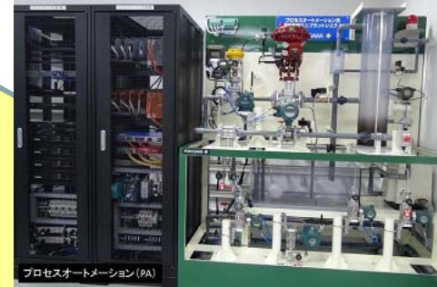
排水・下水プラント
