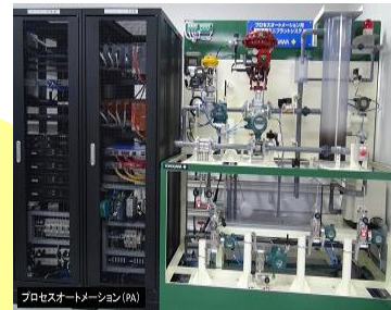
排水・下水プラント
