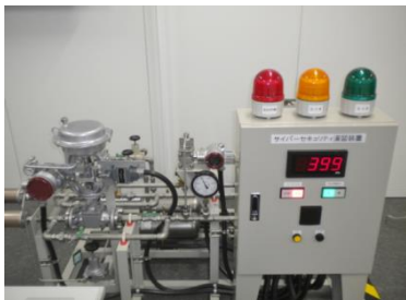
ガスプラント
