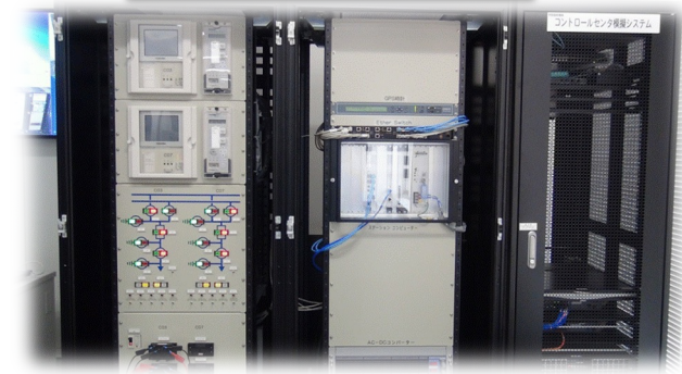
変電模擬プラント
